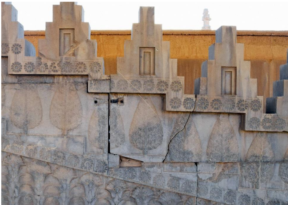
شکل ۱۰. شکستگی سنگ نمای پلکان و بخش‌های تعمیر شده. پلکان شرقی تالار ستوندار بزرگ، تخت جمشید (عکس از ز. زهبری).
