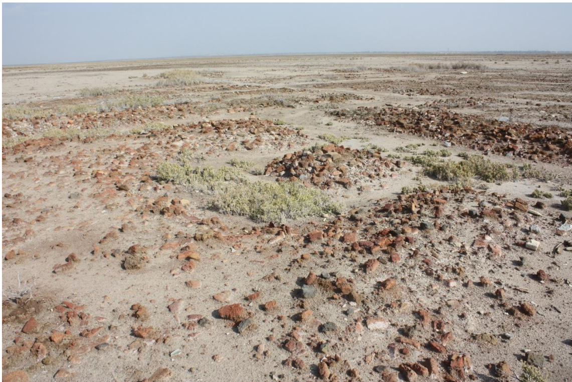
شکل ۴: بقایای سازه‌های معماری خور چخا با استفاده از مصالح آجرقرمز رنگ و ملات ساروج که بر اثر فرسایش طبیعی و قرارگیری دائم در معرض جزر و مد دریا تخریب شده است.
